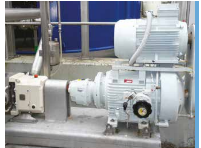
Abfallbehandlungsanlage: Einsatz im Freien mit Kreiskolbenpumpe, 11 kW-Einheit mit aufgesetztem Motor
