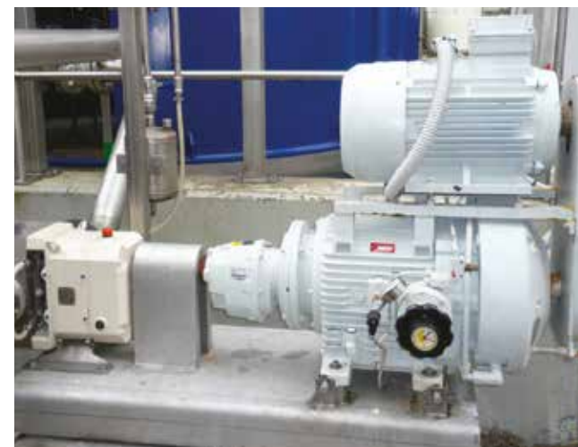
Impianto trattamento rifiuti: applicazione a cielo aperto con pompa a lobi, unità da 11 kW con motore sovrapposto
