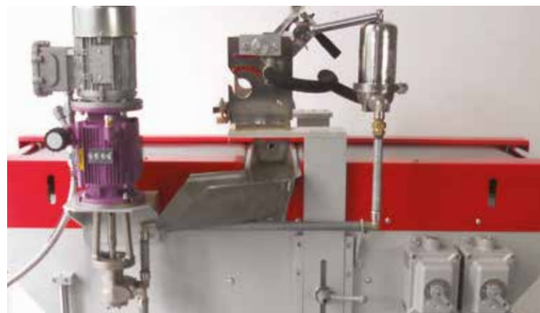
Machine à peindre : variateur K2 sur pompe doseuse (zone Atex)
