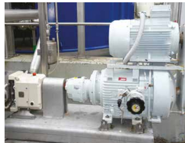
Installation traitement des déchets : application à ciel ouvert avec pompe à lobes, unité de 11 kW avec moteur superposé
