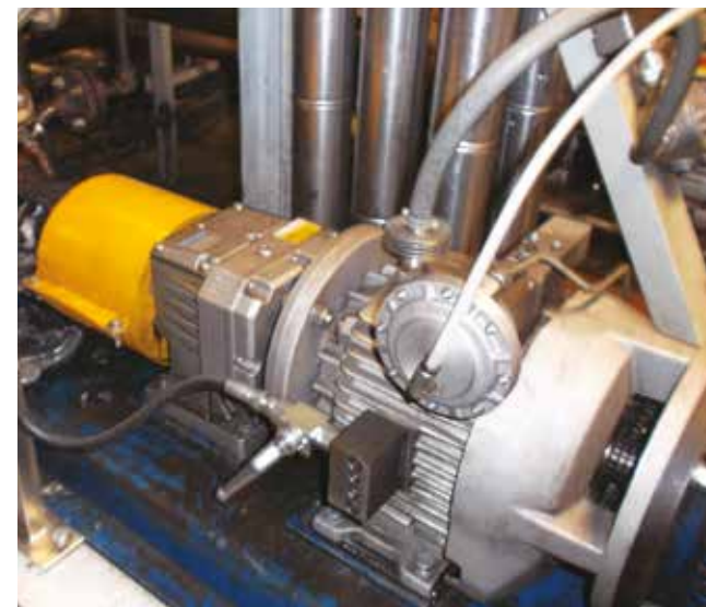
Installation chimique : variateur K5 avec contrôle à distance pneumatique
